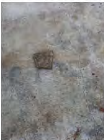
Foto 17: asbestverdacht materiaal proefgat 116
