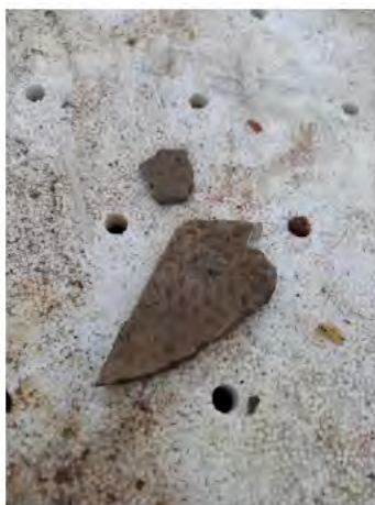
Foto 20: asbestverdacht materiaal proefgat 116
