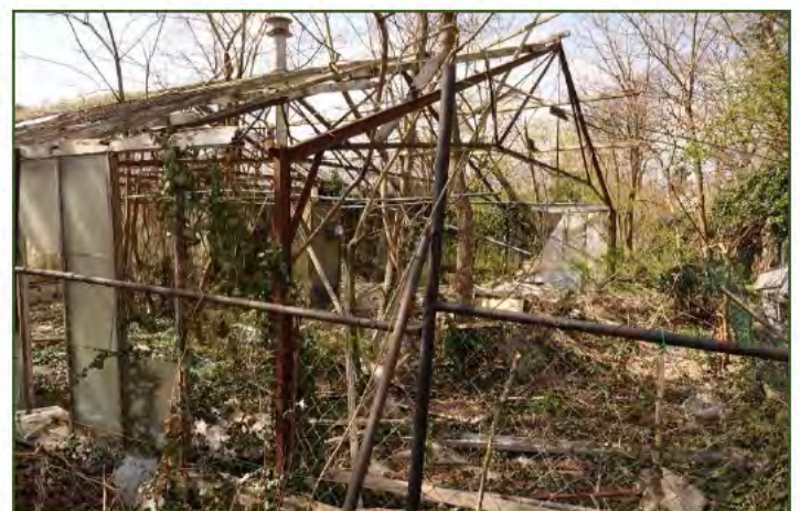
Fig. 2.4 Deel vervallen kas (bron: FF Solutions)
